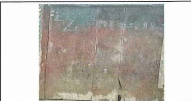
Foto 6: Sustrucción de puerta.
